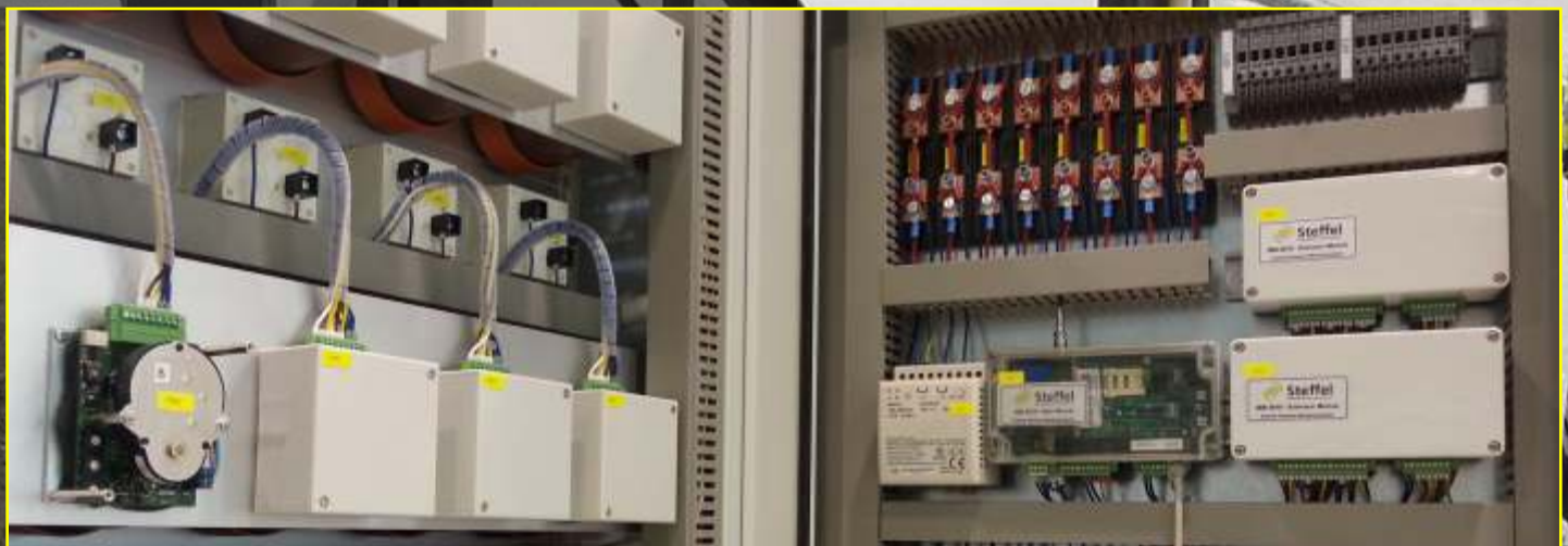
Einbaubeispiel aus dem LKS: Per Schrittmotor ferngesteuertes Multikanal-Schutzstromgerät, alle Mess- und Steuerkanäle an nur einem ISM2010 Fernwirkgerät.
